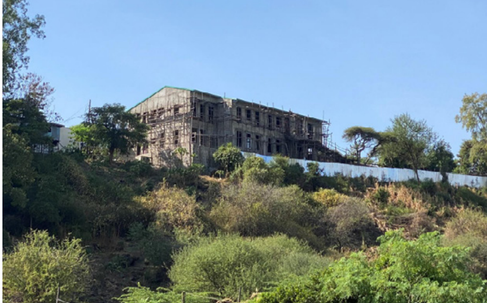
Nybygget på ca. 640 kvm med operasjonsavdeling i første etasje ligger fint til på en høyde med utsikt over kratersjøene Lake Abaya og Lake Chamo. Foto: Thom Topstad
